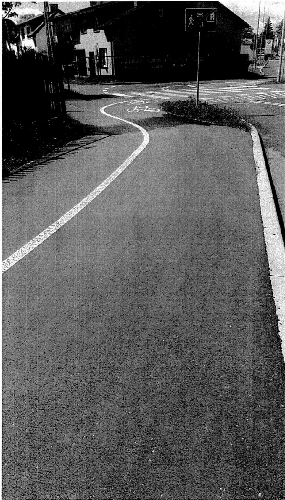
9) Jezdnia zachodnia – skrzyżowanie ul. Szara/Płaska – spękania po walcu - wymiana nawierzchni na dojeździe do przejścia dla pieszych – 25 \times 4 = 100 \text{ m}^2
