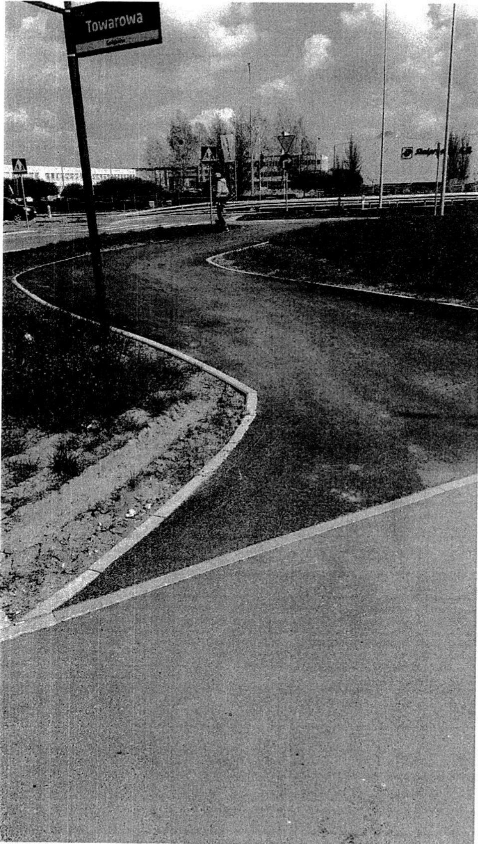
14) Ul. Żółkiewskiego – jezdnia południowa – łącznik wzdłuż ul. Kozienickiej – wymiana nawierzchni - 30 \times 3 = 90 \text{ m}^2
