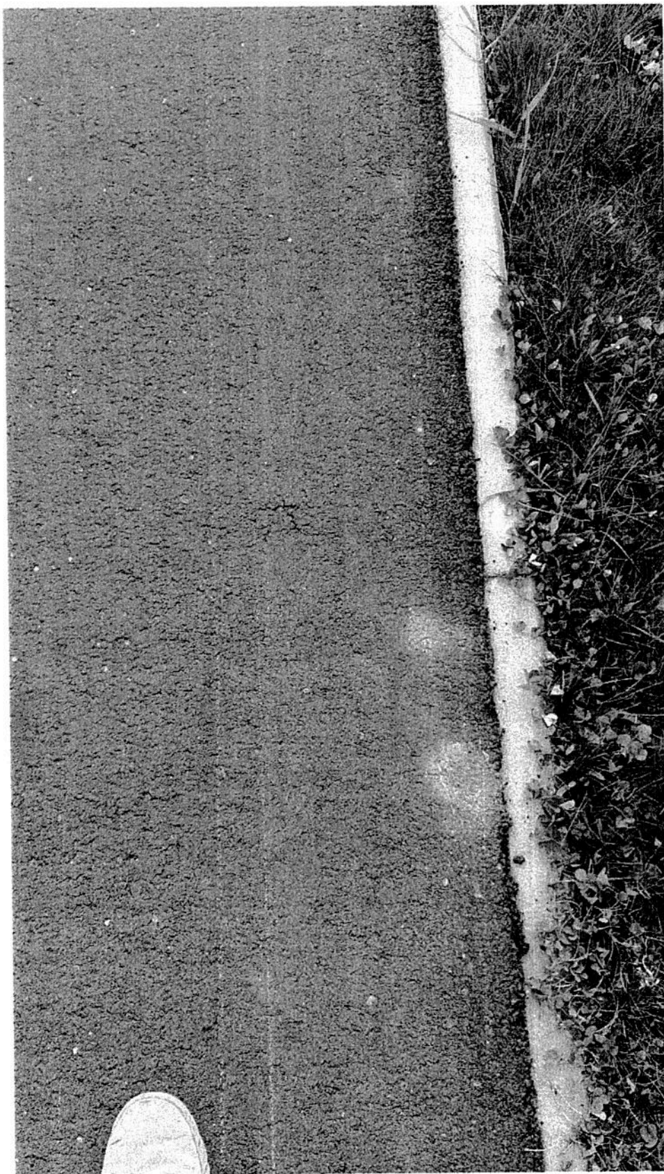
4) Jezdnia północna – ścieżka koło trzeciego zjazdu od wiaduktu do ronda Ks. J. Popiełuszki – zalać pęknięcie masą bitumiczną z pistoletu
