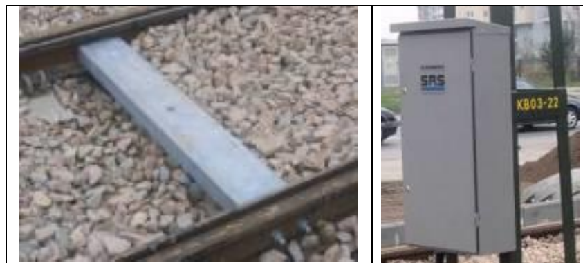
Rysunek 6. Przykład smarownicy torowej SRS oraz szafy z aparaturą sterowniczą smarownicy ( http://www.transportszynowy.pl )
